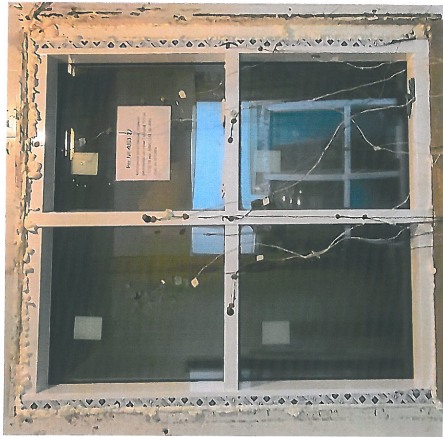
Фото 3. Светопрозрачная конструкция № 4831-22 в климатической камере (теплая сторона)
